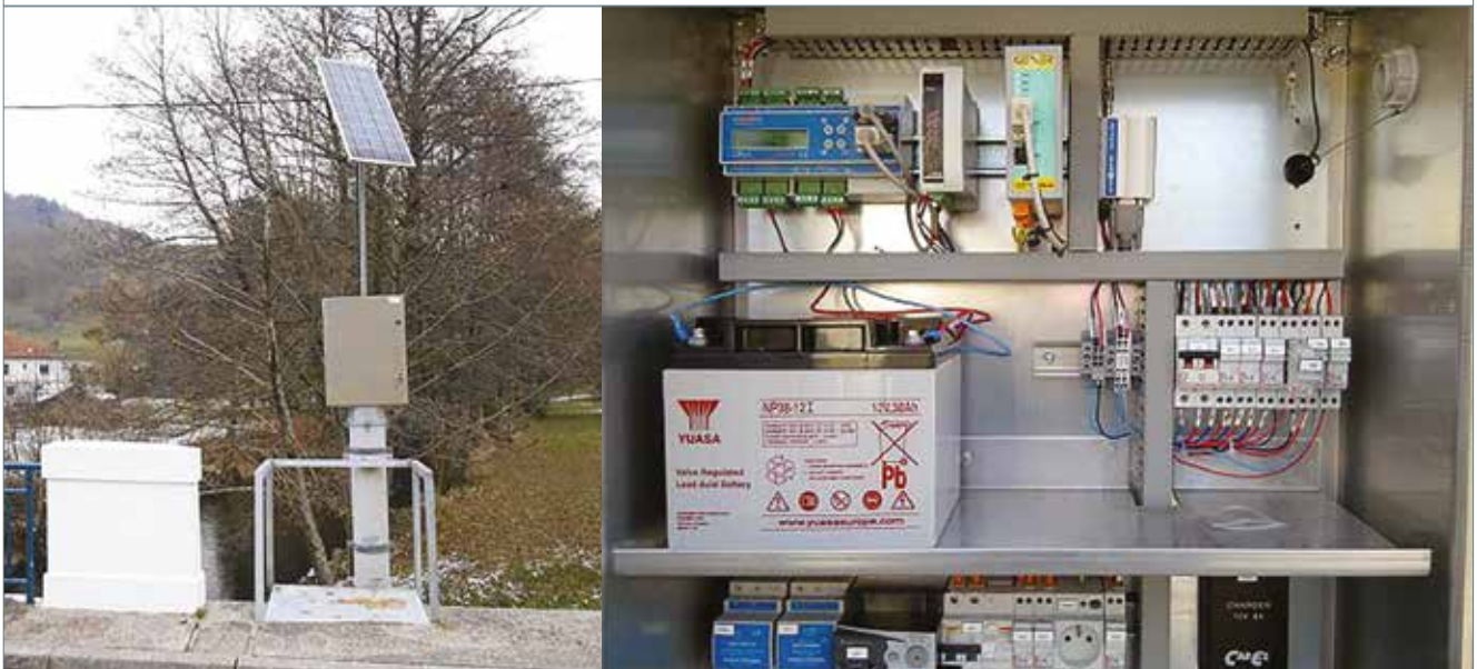
FIGURE 3.2 : COFFRET D'UNE STATION HYDROMÉTRIQUE À RELATION HAUTEUR-DÉBIT À L'AMONT D'UN PONT, LA MOSELLE À FRESSE SUR MOSELLE, 72 KM 2 (DREAL GRAND EST, UH MEUSE MOSELLE)
